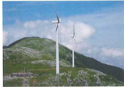
四国カルスト(風力発電所)
